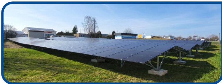
PVA am Trinkwasserhochbehälter
