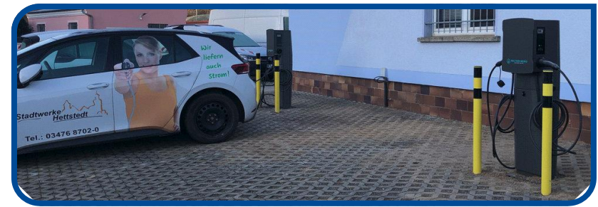
Mitarbeiterladepunkte auf dem Betriebshof
